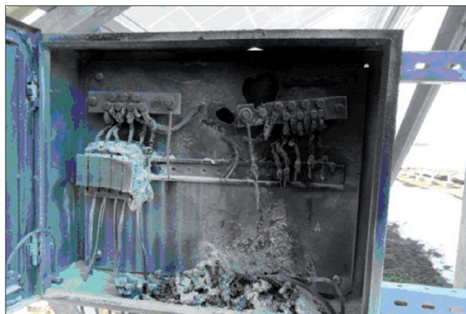
Rys. 2. Spalona rozdzielnica DC
